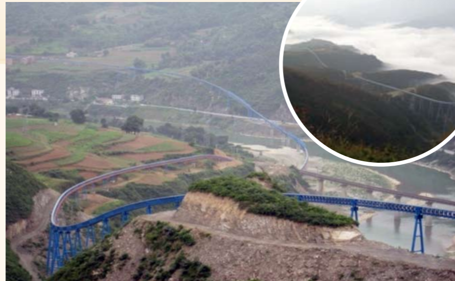
陕西尧柏水泥厂DG350型管状带式输送机项目 The Dg350 Pipe Belt Conveyor of Yaobai Cement Co., Ltd. in Shanxi
